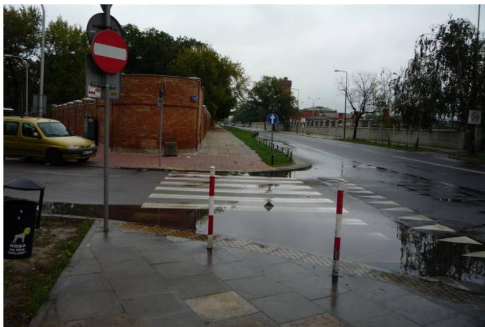
Wadliwe odwodnienie przejścia dla pieszych
