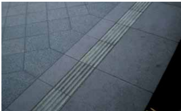
Fot. 1. Krawędź peronowa na dworcu Wrocław Główny – rozwiązanie niezgodne z dotychczasowymi realizacjami w Polsce, ale za to lepsze. (KR)
