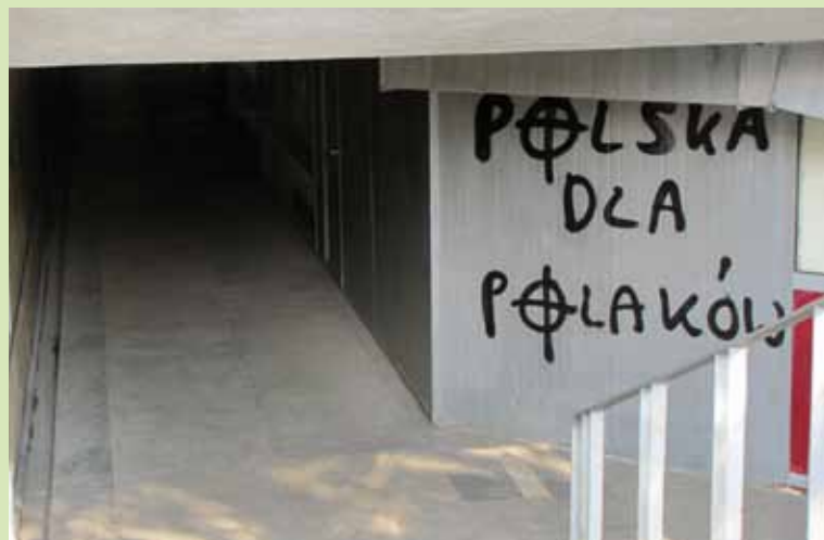
Fot. 3. Przejście podziemne stanowiło doskonałe schronienie dla patologii. (AB)
