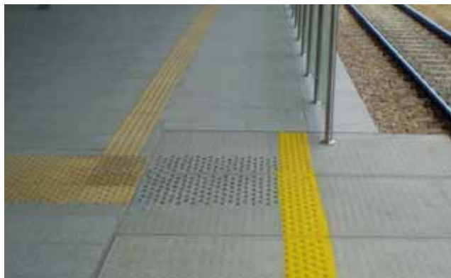
Fot. 3. Zbyt wąskie, dwudziestocentymetrowe pasy ostrzegawcze (prefabrykowane płyty peronowe) – standard większości nowych peronów w Polsce (na zdjęciu Warszawa Stadion). (KR)
