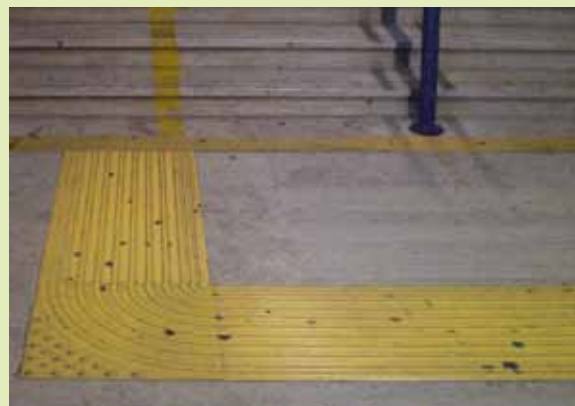
Fot. 14. W rzymskim metrze zastosowano interesujące zakręty na załamaniach ścieżki, a także pas oznakowania dla niedowidzących wzdłuż trasy na schodach (Rzym). (KR)
