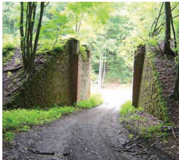
...a innym tajemniczej dostojności i - mimo zniszczeń - także uporu w trwaniu pod naporem natury. Na zdjęciu pozostałości wiaduktu na linii Myślice - Elbląg w lesie na północ od wsi Kwietniewo (MJ)
